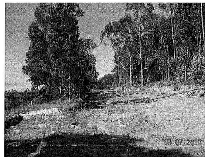
Foto 36.- Segunda zona excavada en sentido N-S y restante superficie de cautela. Posterior a la retirada de la maleza perimetralmente.
