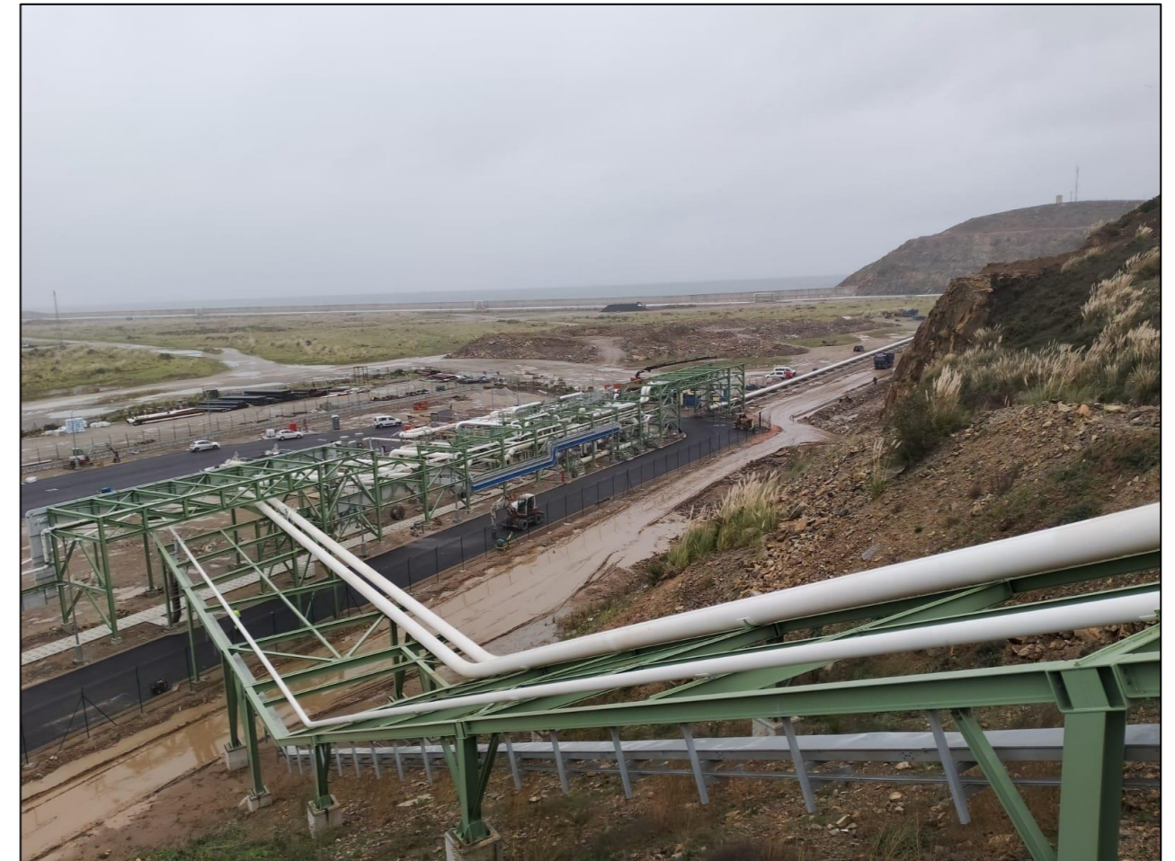
Figura 3. Vista poliducto a las instalaciones portuarias de REPSOL
